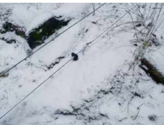
En isolator skruvad i marken.
